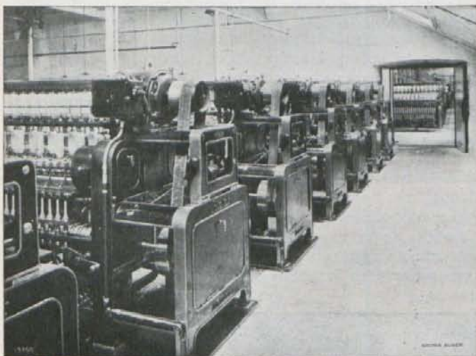
Fig. 3. — Motores Brown Boveri en corto circuito accionando continuas de hilar mediante correa, con dispositivo desligante
