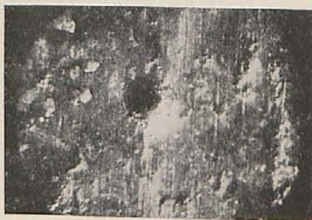
Fig. 27. -- Vista de la corrosión del hierro fundido.
