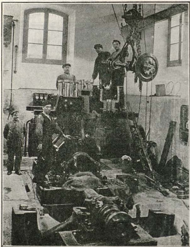
Central de reserva de Coruña, en periodo de montaje.
