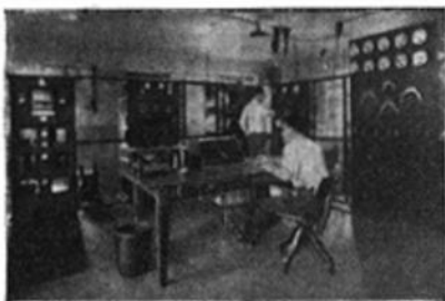
Sala de control
