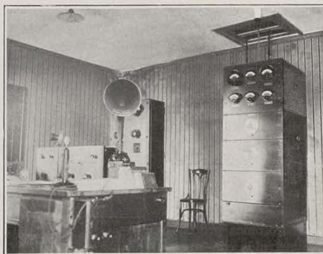
Equipo transmisor (Edificio Monte Igueldo.)
