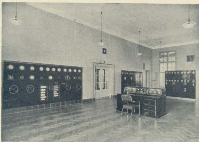
Cuadro de fuerza y control de circulación de agua Unidad osciladora moduladora. Cuadro de maniobra.
