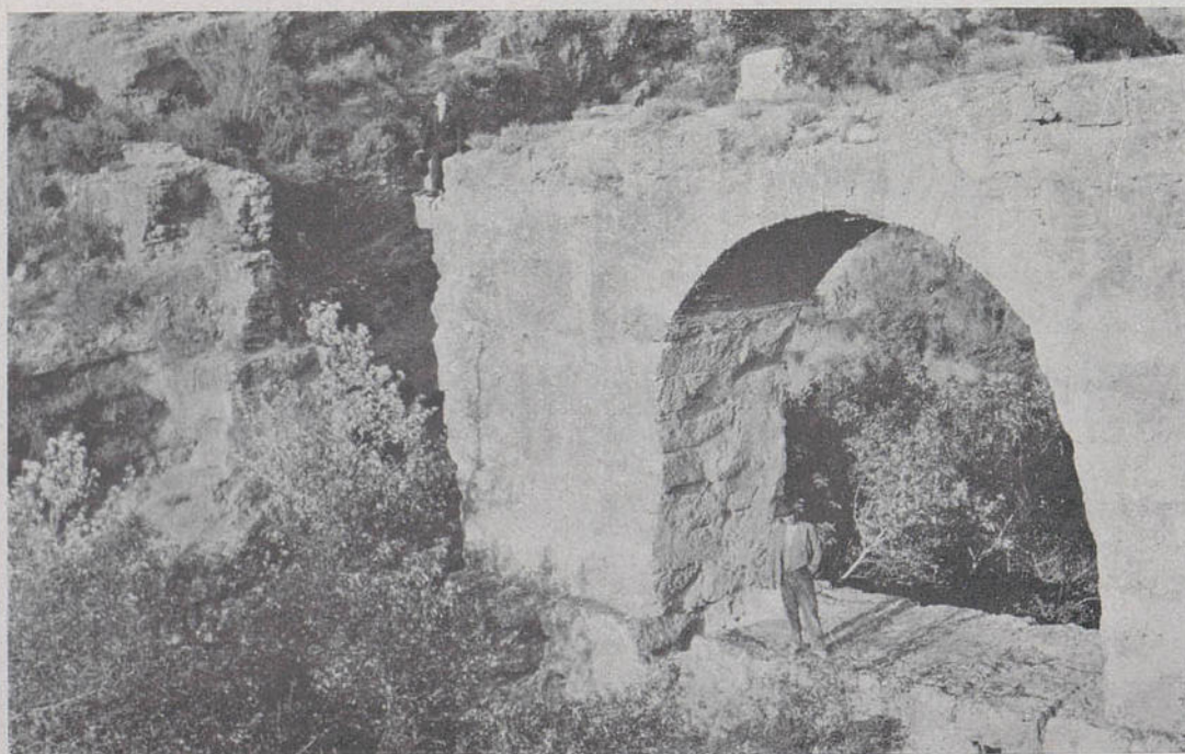
Acueducto romano destruido.
