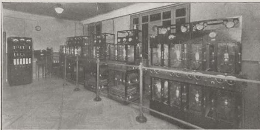
Sala de transmisión de Unión Radio EAJ 7 Madrid
