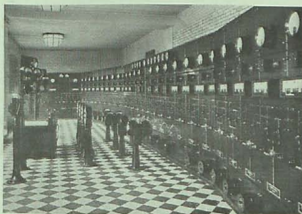
Cuadro blindado de distribución G.E.C. para maniobra a distancia instalado en la Central de los Tranvías de Glasgow 39 Paneles—6,600 Voltios—350,000 KVA.
